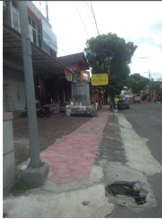
Penutup saluran drainase jebol
